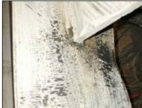
(d) Yielding and Warping of Column
